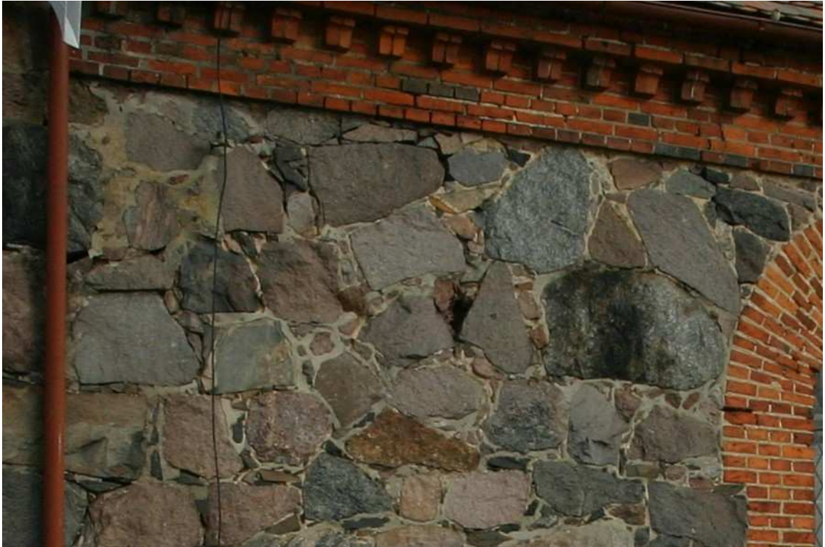
Fot.4. Lubiewo, kościół pw. św. Mikołaja, elewacja południowa, spękanie strukturalne i rozluźnienie wążku widoczne w górnej partii murów obwodowych nawy. Na zdjęciu widoczne także ślady bieżących napraw – spoinowanie wykonane szarą zaprawą cementową.
