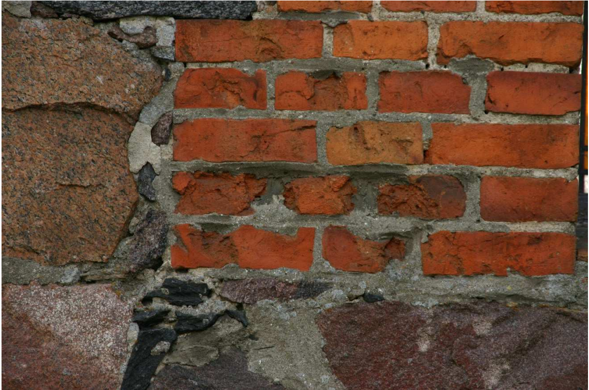
Fot.10. Lubiewo, kościół pw. św. Mikołaja, stan zachowania wątku ceglanego. Naprawy w obrębie spoin wykonano szczelną zaprawą cementową.
