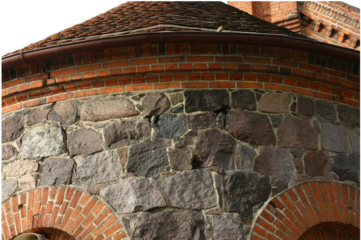
Fot.6. Lubiewo, kościół pw. św. Mikołaja, apsyda prezbiterium. Spękania widoczne w wątku kamiennym znajdują swoją kontynuację także w obrębie ceglanej korony murów.
