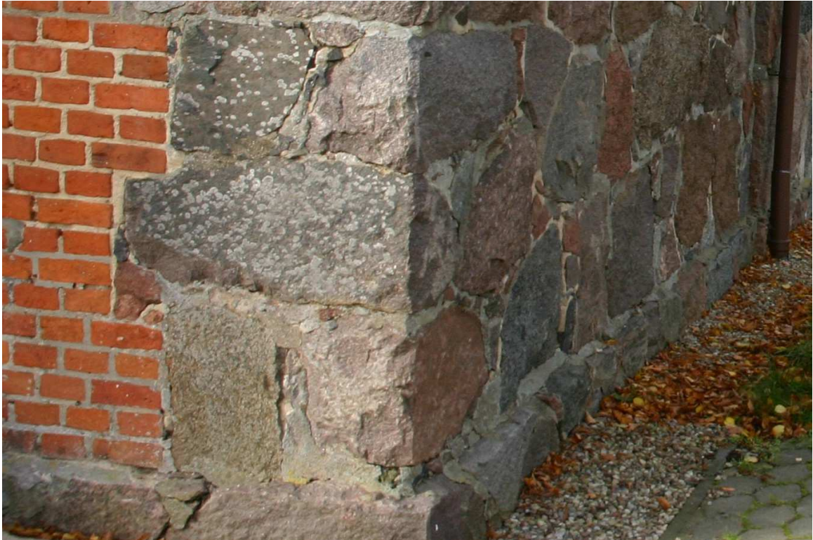
Fot.8. Lubiewo, kościół pw. św. Mikołaja, północno – zachodni narożnik nawy północnej. Na zdjęciu widoczne nawarstwienia organiczne – kolonie porostów kalcytofilnych, pokrywające wątek kamienny.
