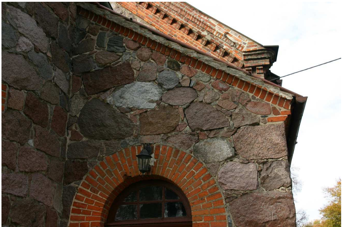
Fot.7. Lubiewo, kościół pw. św. Mikołaja, Spękania widoczne w wątku kamiennym północno-wschodniej części prezbiterium.
