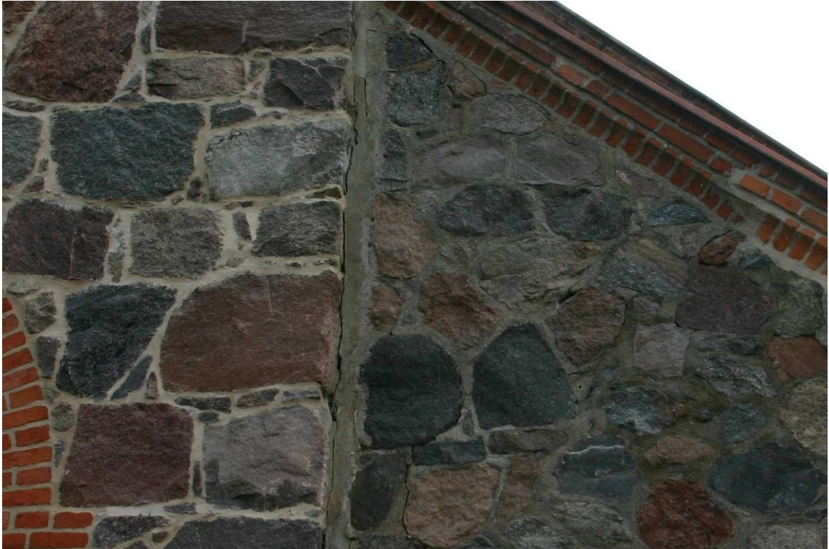
Fot.2. Lubiewo, kościół pw. św. Mikołaja, elewacja wschodnia. Słabe przewiązanie wątku typowe dla konstrukcji z kamienia polnego jest powodem powstawania spękań strukturalnych. Na zdjęciu pęknięcie pomiędzy bryłą wieży a kruchłą – jak widać „naprawiane” już nieskutecznie zaprawą cementową.
