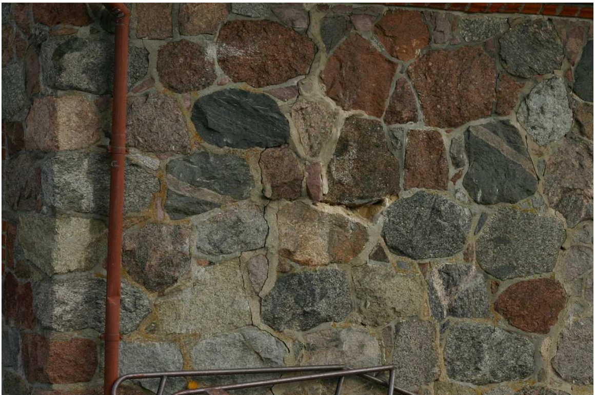
Fot.3. Lubiewo, kościół pw. św. Mikołaja, elewacja południowa, spękanie strukturalne w obrębie kruchty.
