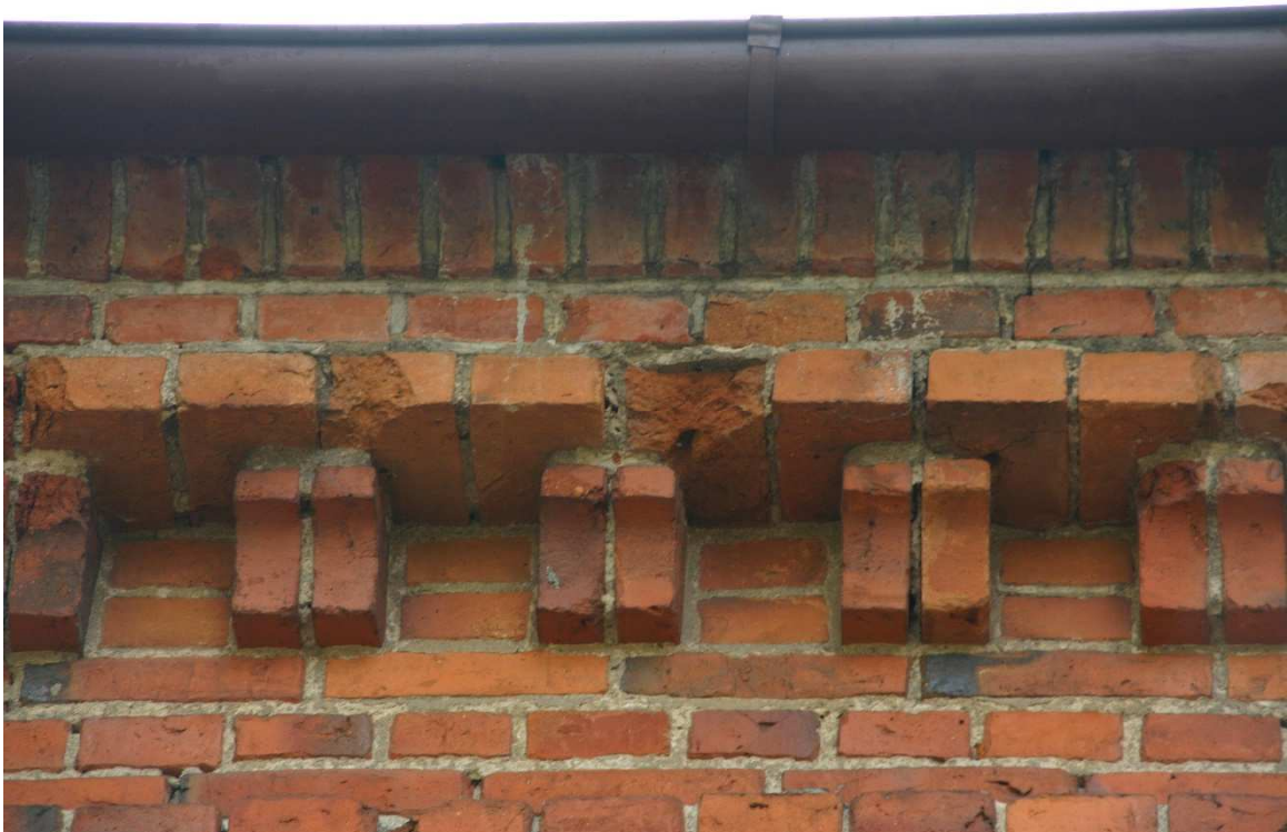
Fot.9. Lubiewo, kościół pw. św. Mikołaja, elewacja północna. Typowe ubytki fryzu korony murów mają charakter mechaniczny.
