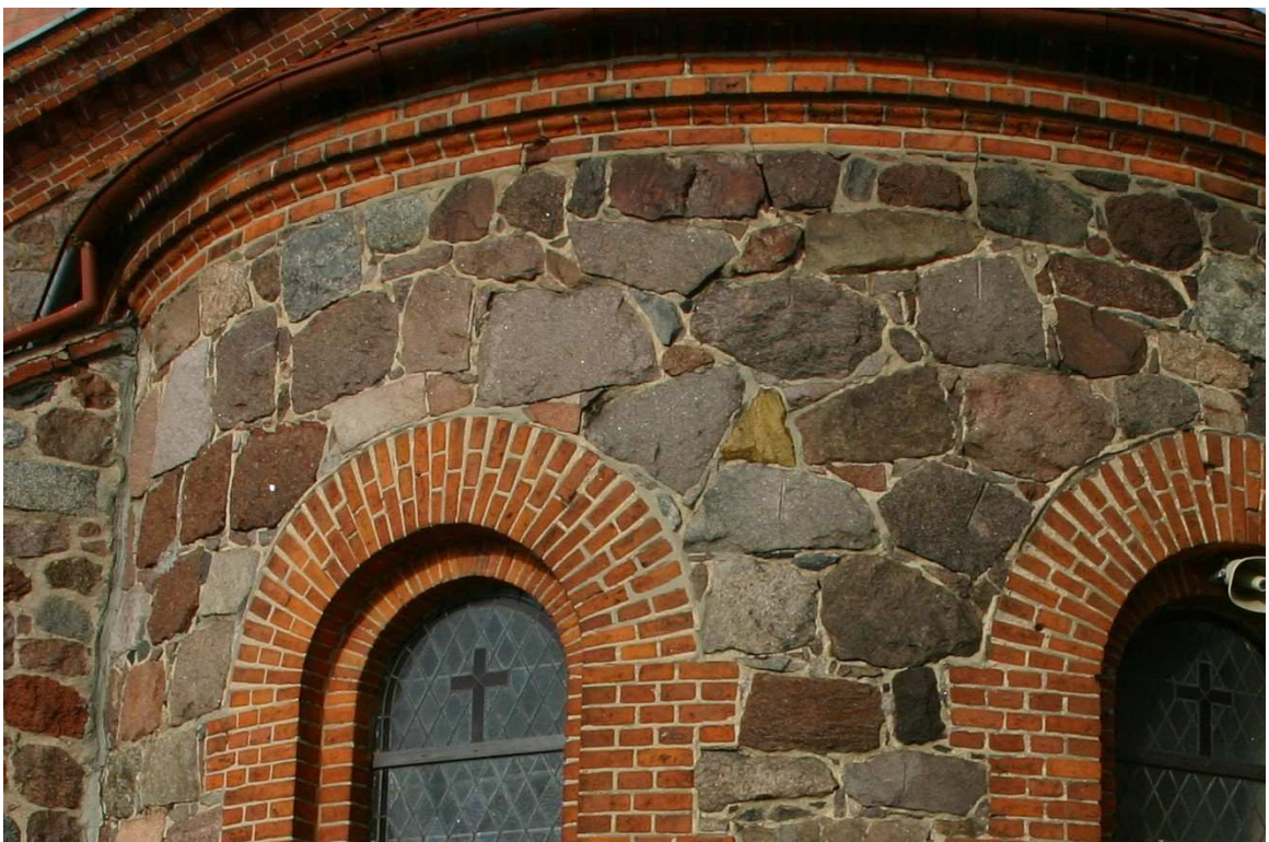
Fot.5. Lubiewo, kościół pw. św. Mikołaja, apsyda prezbiterium. W górnej części ściany widoczne ubytki spoin i rozluźnienie wążku kamiennego.
