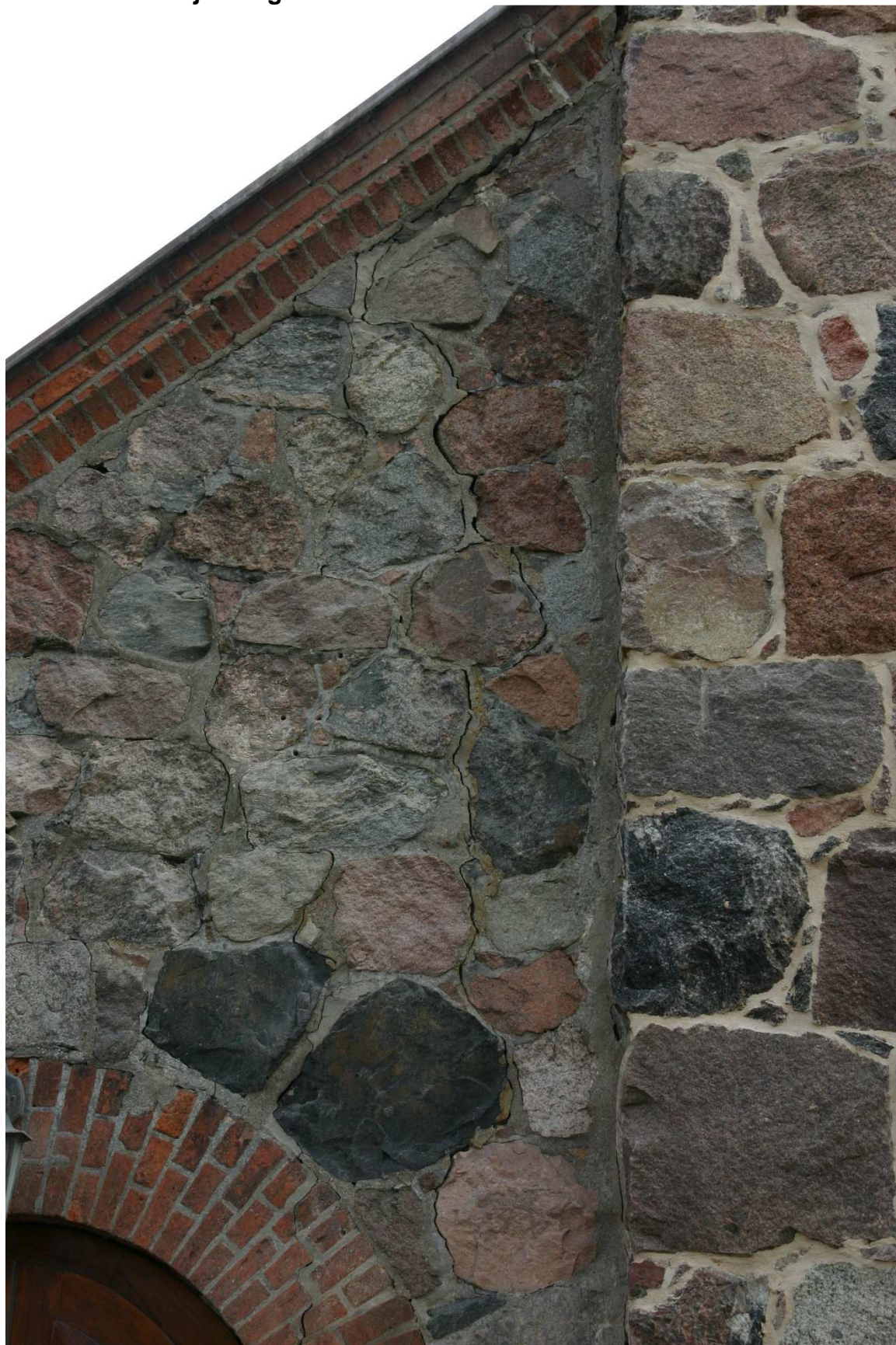
Fot.1. Lubiewo, kościół pw. św. Mikołaja, elewacja wschodnia. Słabe przewiązanie wątku typowe dla konstrukcji z kamienia polnego jest powodem powstawania spękań strukturalnych.
