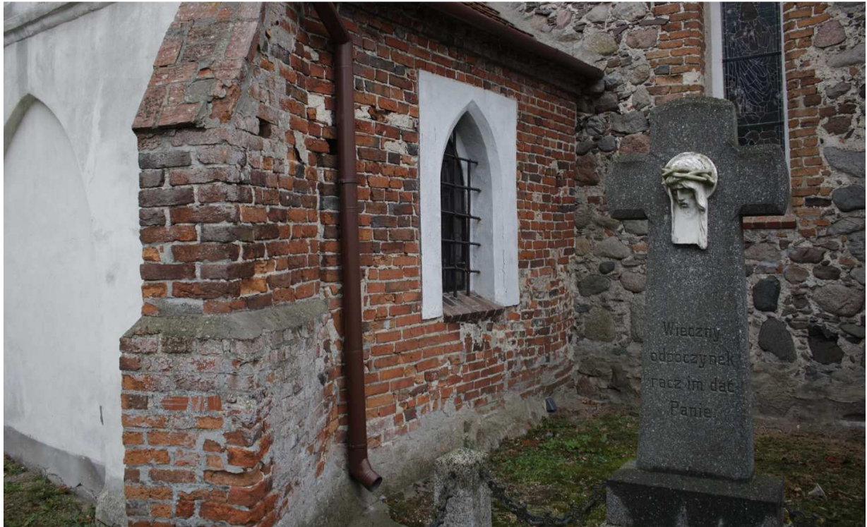
Fot.15. Lisewo, kościół pw. Podwyższenia Krzyża Świętego. Elewacja północna, wążek ceglany przypór kruchty północnej jest silnie wypłukany i pokryty obfitymi nawarstwieniami biologicznymi w kolorze szarym. Lokalnie obserwuje się zniszczenia charakterystyczne dla korozji solnej – tłuszczenie cegły. Również tutaj obserwuje się niezbyt szczęśliwe odprowadzenie wody opadowej, bezpośrednio na trawnik przy kruchcie.
