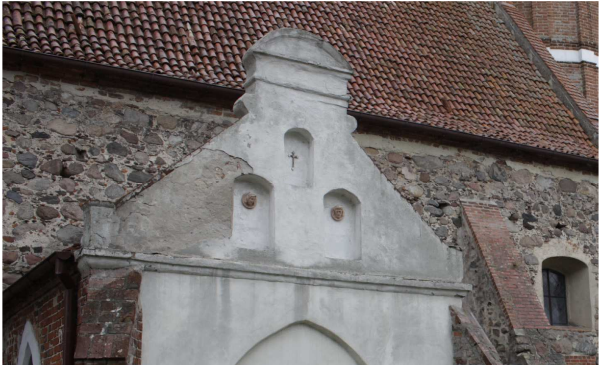
Fot.13. Lisewo, kościół pw. Podwyższenia Krzyża Świętego. Elewacja południowa. Tynki kruchty południowej – widoczne złuszczenia powierzchniowej warstwy tynków. Zaprawa jest silnie wypłukana – odstąpiła powierzchnia pudruje się.
