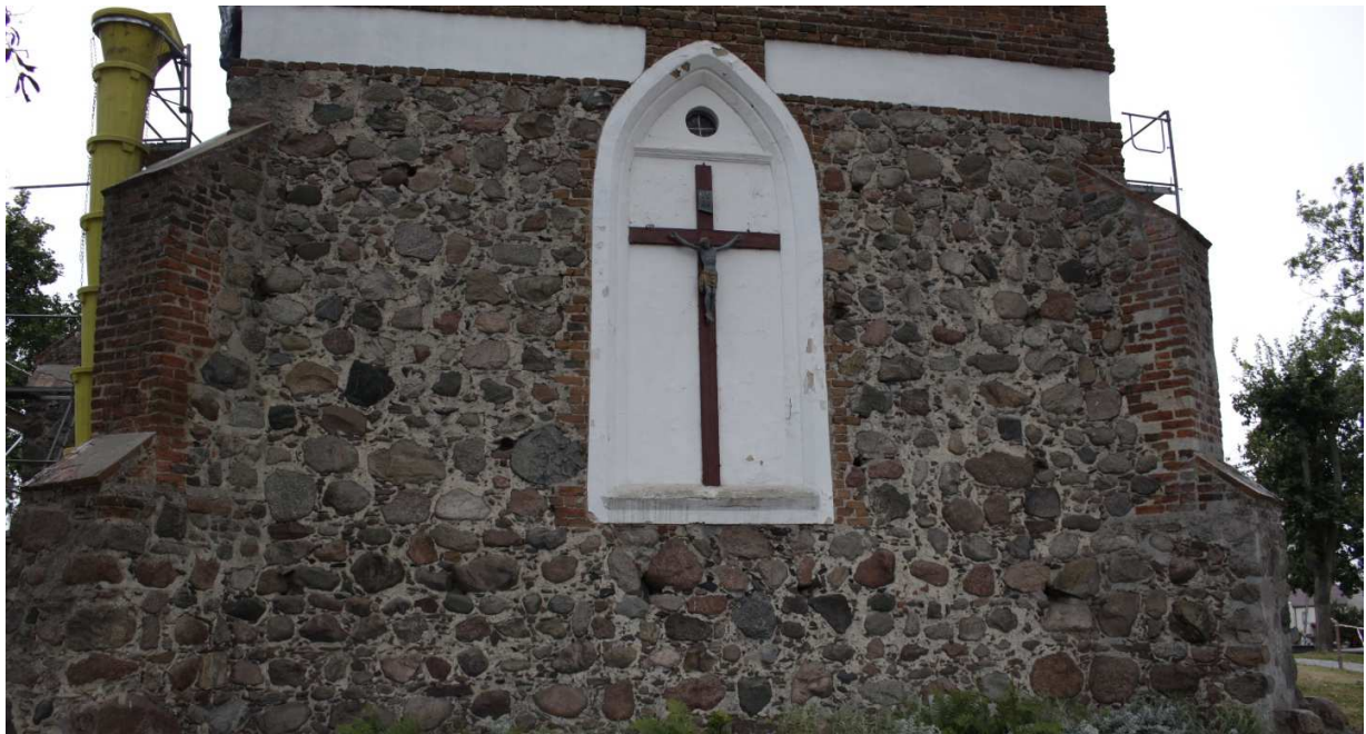
Fot.3. Lisewo, kościół pw. Podwyższenia Krzyża Świętego, widok ogólny na elewację wschodnią. Na zdjęciu widoczne także nieprawidłowo wykonane tynki blendy prezbiterium. Tynk pokrywa blendę wraz z profilowaniem. Zaprawę pobielono farbą emulsyjną.
