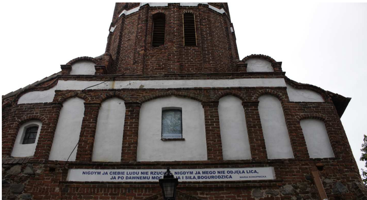
Fot.6. Lisewo, kościół pw. Podwyższenia Krzyża Świętego, widok ogólny na elewację zachodnią. Tynki fryzu łuszczą w wyniku działania wody opadowej – przerwy gzyms nad fryzem.
