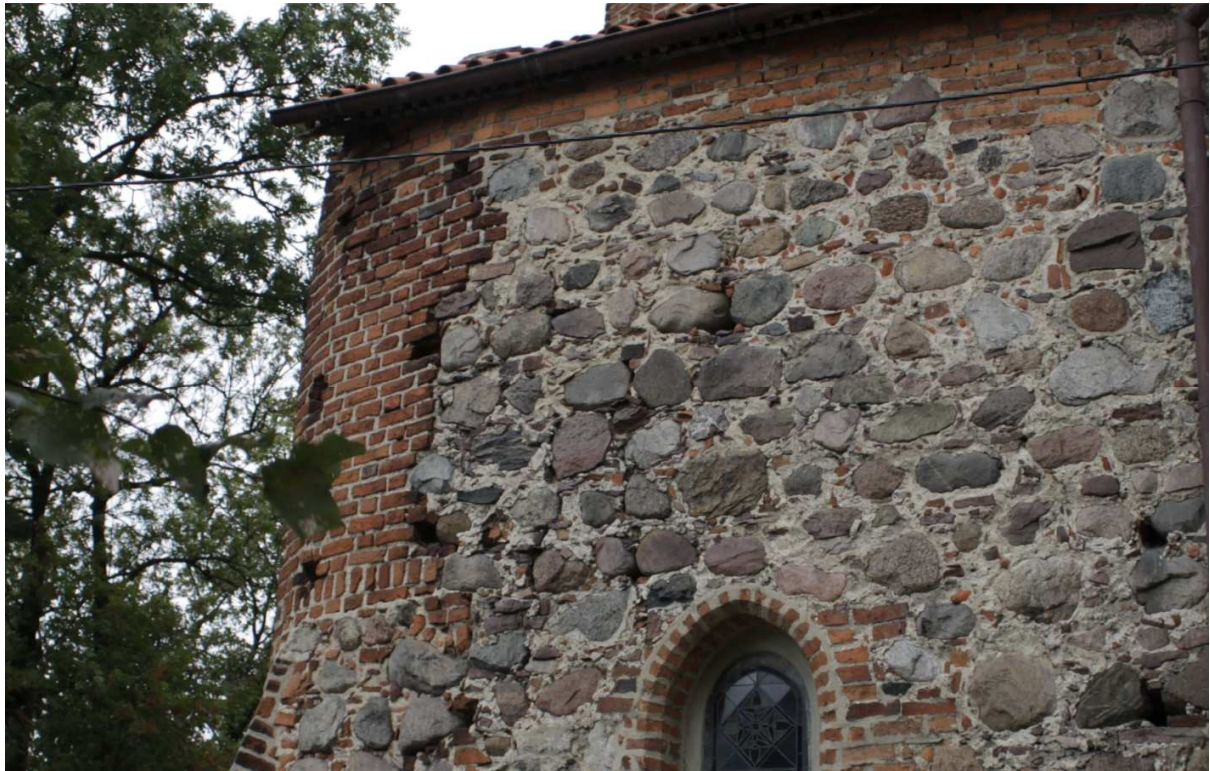
Fot.10. Lisewo, kościół pw. Podwyższenia Krzyża Świętego, elewacja południowa kruchty zachodniej. Na zdjęciu widoczne spękania wątku kamiennego oraz spękanie na granicy wątków kamień-cegła.
