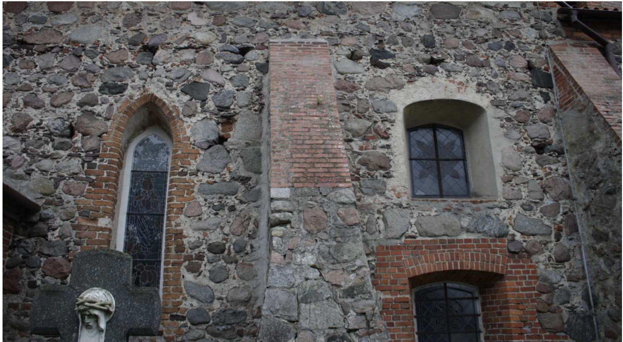
Fot.17. Lisewo, kościół pw. Podwyższenia Krzyża Świętego. Elewacja północna. Bardzo starannie poprowadzona naprawa wzdłuż połączenia korpusu i przypory wskazywać może na problemy ze statyką tego elementu.
