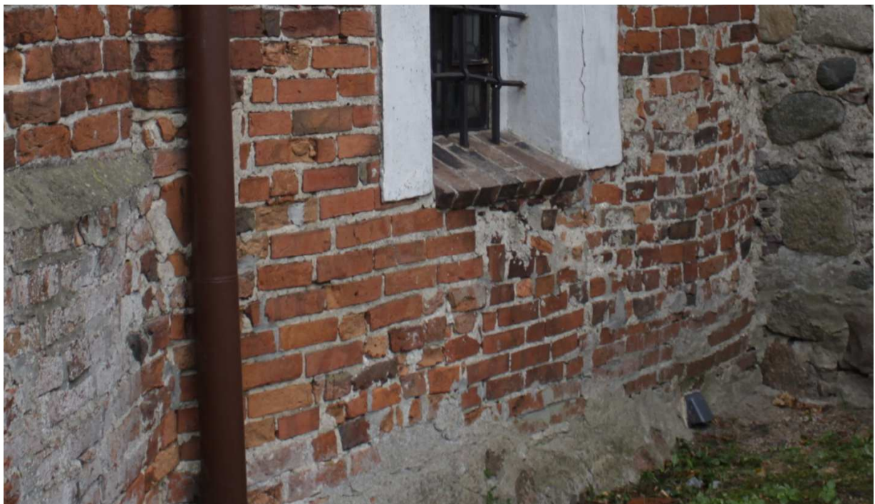
Fot.16. Lisewo, kościół pw. Podwyższenia Krzyża Świętego. Kruchta północna, w dolnej części ściany widoczne są bardzo niestaranne naprawy murarskie.
