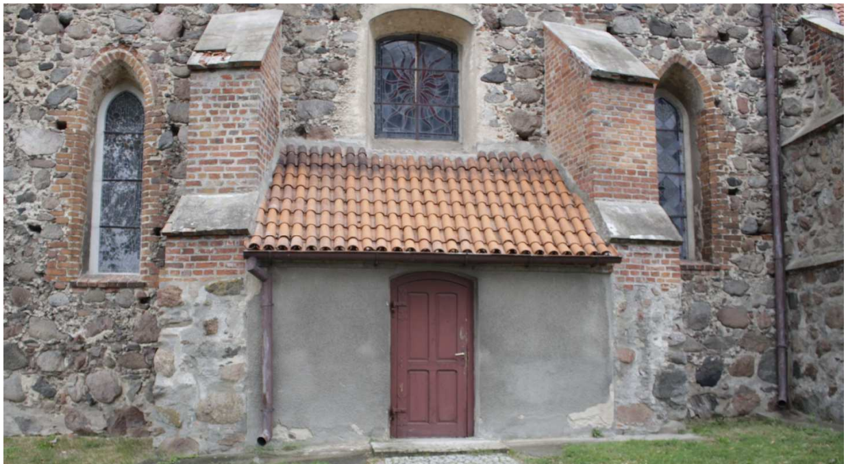
Fot.14. Lisewo, kościół pw. Podwyższenia Krzyża Świętego. Kruchta południowa. Na zdjęciu widoczne naprawy – wążki kamiennego oraz pokrycie czap przypór wykonane ze szczelnej zaprawy betonowej. Górna czapa zachodniej przypory jest uszkodzona.
