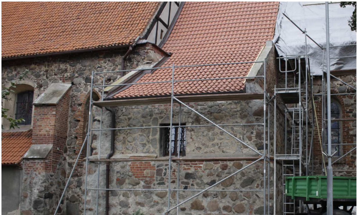
Fot.18. Lisewo, kościół pw. Podwyższenia Krzyża Świętego. Elewacja południowa. Na zdjęciu widoczna bryła zakrystii z otworem okiennym o wtórnie zmienionym kształcie.
