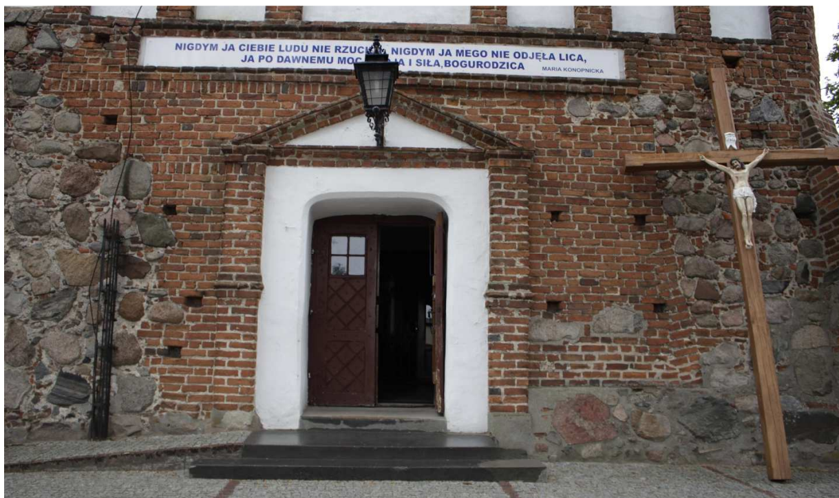
Fot.5. Lisewo, kościół pw. Podwyższenia Krzyża Świętego, widok ogólny na elewację zachodnią. Na elewacji zachodniej uwagę zwraca pol-brukowy chodnik doprowadzony do samej elewacji kościoła. Rozwiązanie takie sprzyja zawilgacaniu murów obwodowych.
