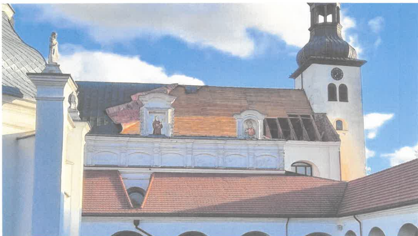
Widok połaci północnej przed zabezpieczeniem szkód.
