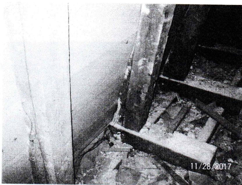
Fot.5. Ubytki spowodowane próchnicą na powierzchni krokwi w prezbiterium.
